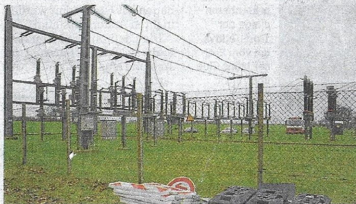
Die Schleswig-Holstein-Netz-AG will unter anderem das Umspannwerk in Höhndorf erneuern.
